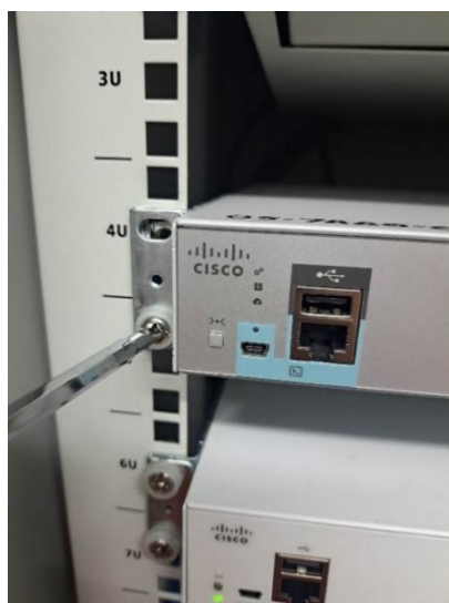
ภาพที่ 4.30 ติดตั้งอุปกรณ์เครือข่ายสวิตช์เลเยอร์ 2
