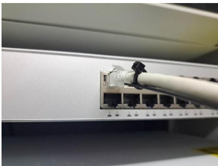
ภาพที่ 4.34 เชื่อมต่อสายสัญญาณ Unshielded Twisted Pair (UTP)
